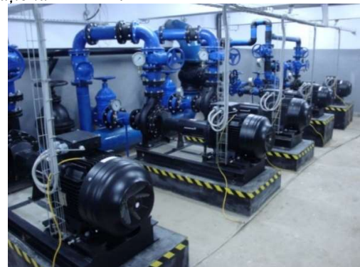
Stație de pompare
