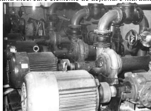
Stație de pompare cu 5 unități, putere instalată de 400 kW, debit maxim de 350 l/s, cu castel de apă H=24 m (1973-1975)
